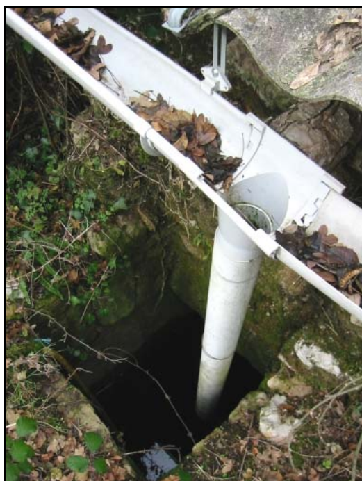
Alimentation d'une citerne souterraine par le collectage des eaux de pluie, au « Château » de La Vacquerie.
